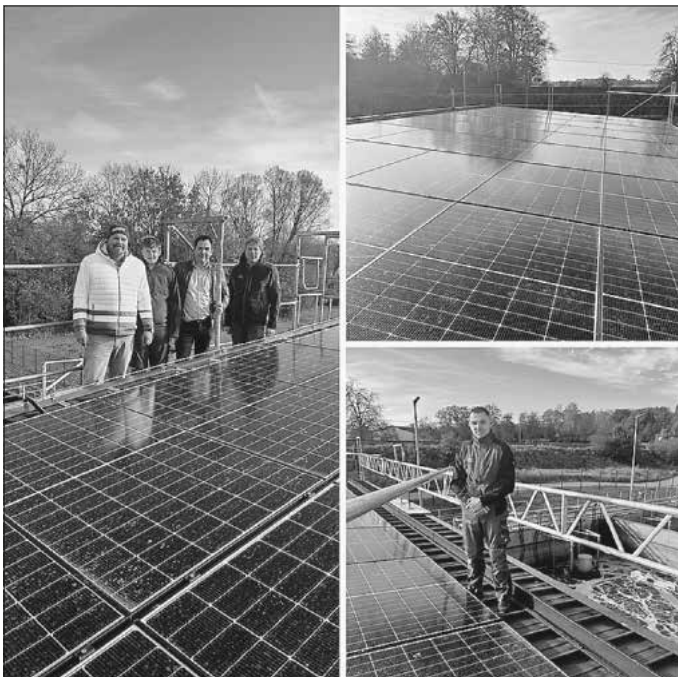
Auf dem beiliegenden Bild sind die Beteiligten bei der Abnahme der Photovoltaikanlage zu sehen, die mit viel Engagement und Fachkenntnis umgesetzt wurde.
